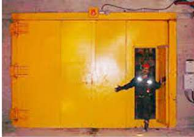
Puertas mineras para control de ventilación
